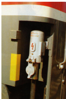
Fig. 4 – Condotta AT a riposo
